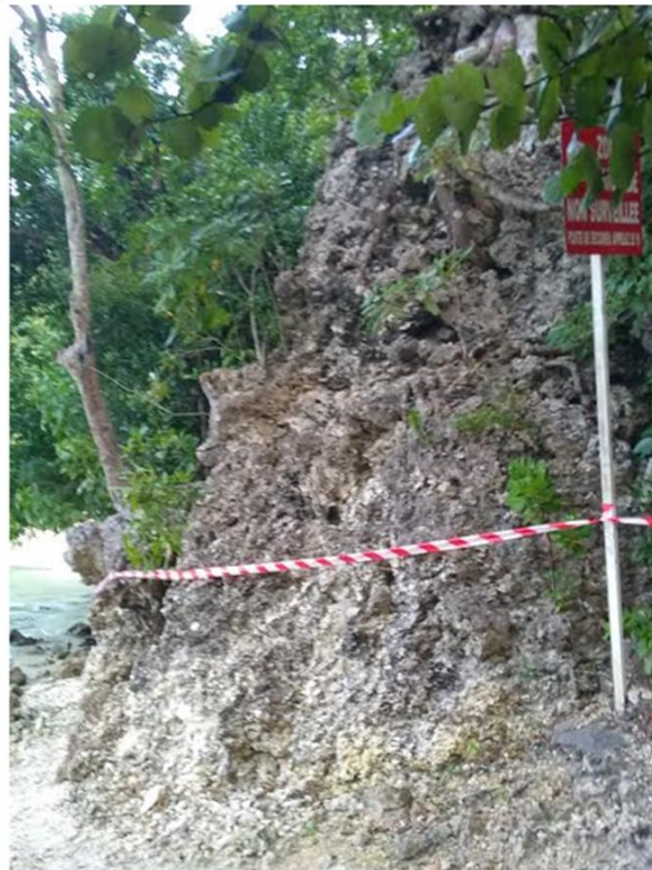
Mise en place de rubalise en bord de passage du public pour prévenir de la dangerosité du site
