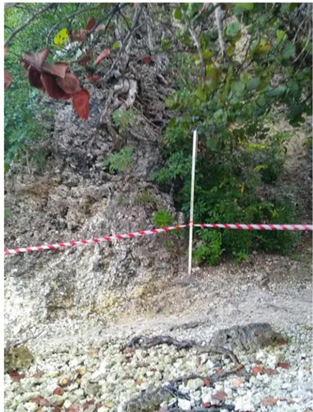
Mise en place de rubalise en bord de passage du public pour prévenir de la dangerosité du site
