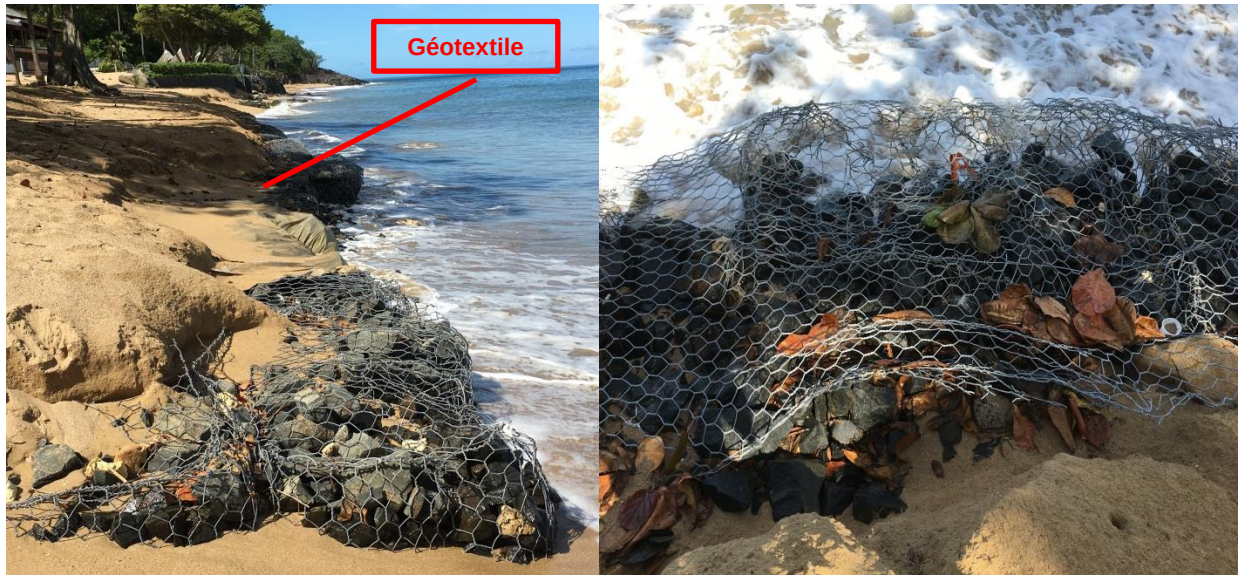
Illustration 8 – Mise à nu et dégradation des gabions et de la couverture géotextile (BRGM, 2016)
