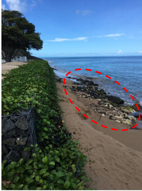
Illustration 10 – Blocs épars découverts en pied d'ouvrage (BRGM, 2016)
