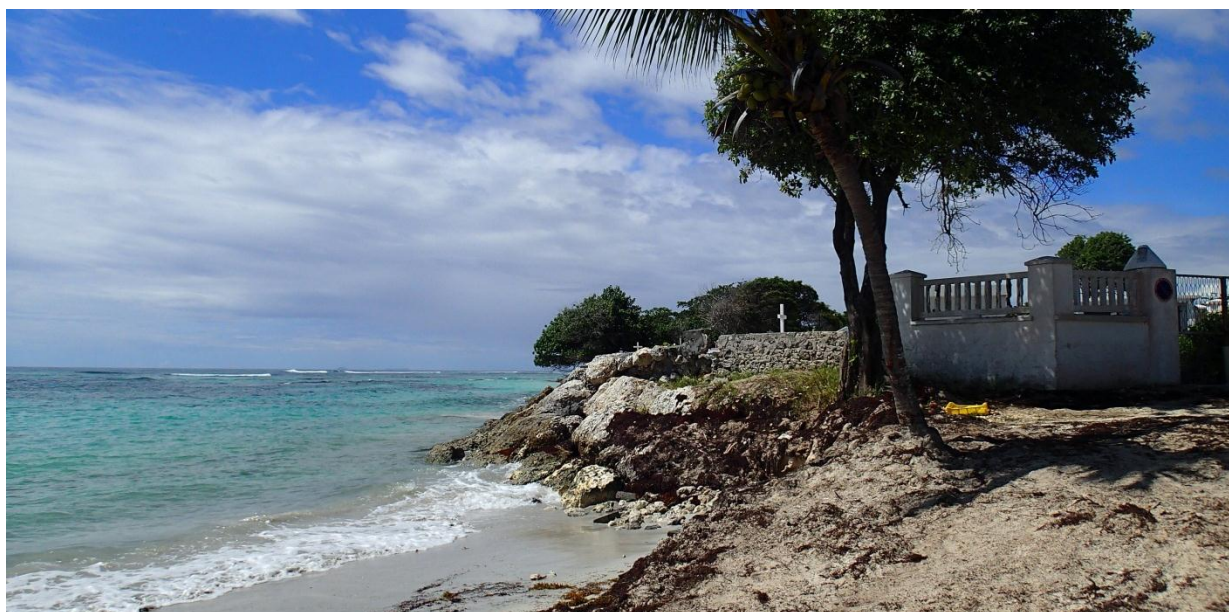
Figure 5 – Enrochement protégeant le cimetière hindou de l'érosion du littoral. En pied d'ouvrage au niveau de l'enrochement la plage a complètement disparue (vu vers l'ouest).
